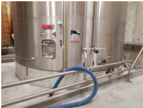
Photo n°1 : base d'une cuve inox
