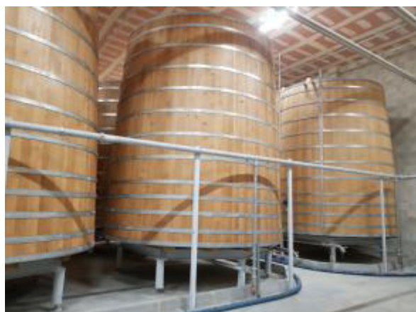
Photo n°1 : vue des tonneaux avec réseau de sprinklage
