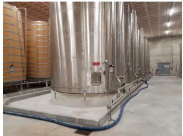
Photo n°2 : alignement de cuves inox
